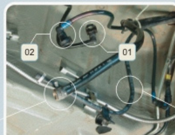
Mangueiras conectadas ao tanque de combustível
