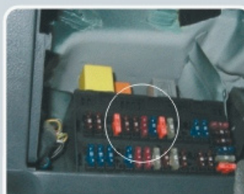
Caixa de relés e fusíveis
