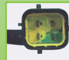
Oxidação no conector
